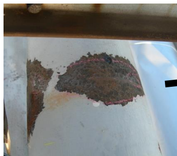
配管バンド部腐食状況
