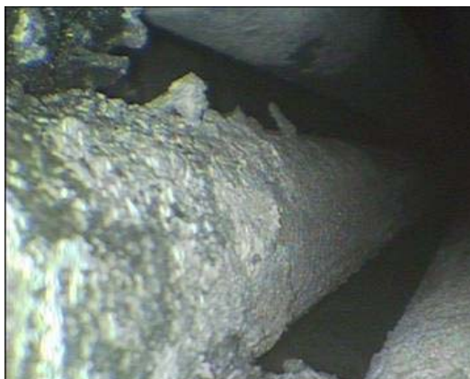
装置内スケール堆積状況確認例
